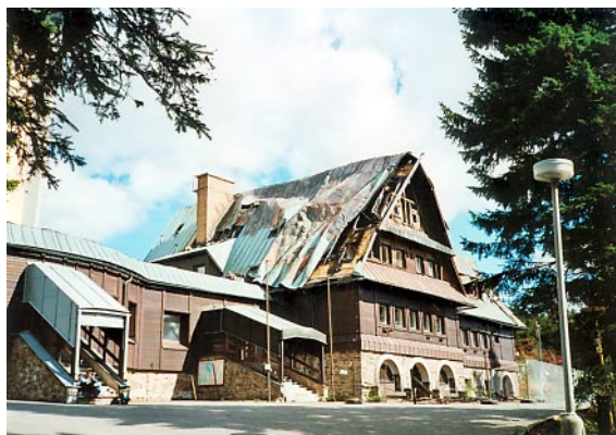
● Schronisko na Suchým vrchu po pożarze...
